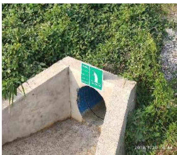
图 7 雨水排口 1 标识牌
