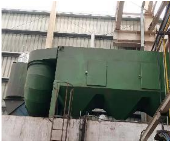
图 3 抛丸废气处理装置
