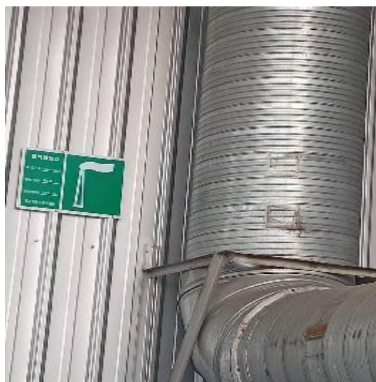
图 6 喷漆排口标识牌
