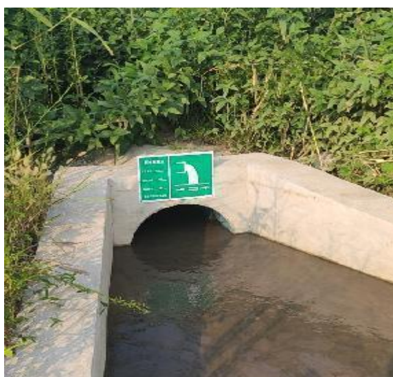
图 9 雨水排口 3 标识牌
