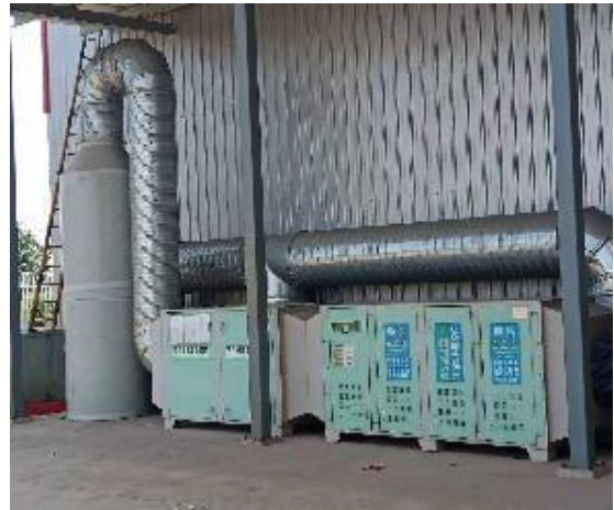
图 4 喷漆废气处理装置
