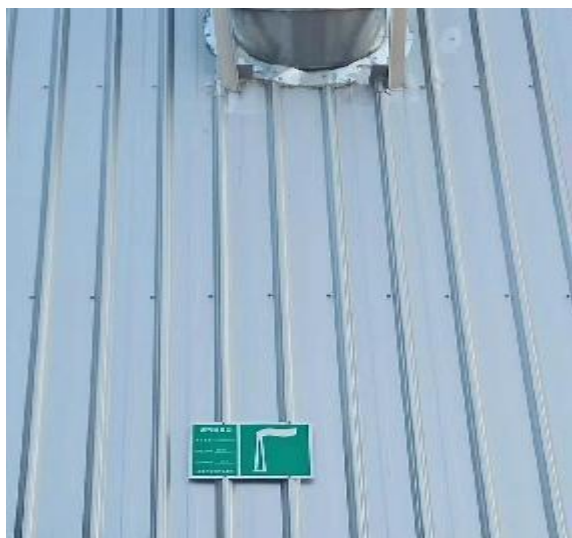
图 5 抛丸排口标识牌
